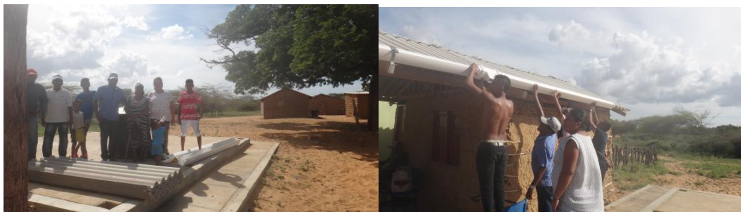
Figura 23. Yanama ara instalación de aprovechamiento de aguas lluvias en la comunidad de Amuruluba
